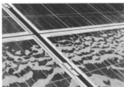
figure 17 : modules couverts de salissures.
